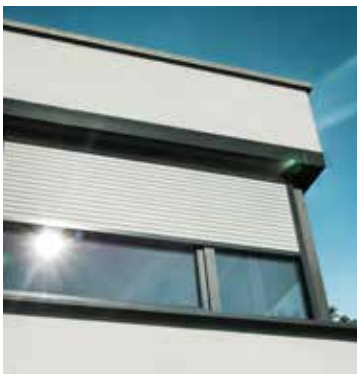
Vorbaurollladen QUADRO flächenbündig mit der Fassade montiert.
